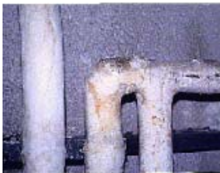
Slika 5: Cevi, izolirane z azbestom 5
