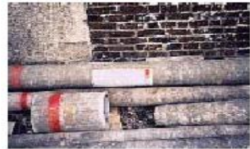
Vodovodne in kanalizacijske cevi
